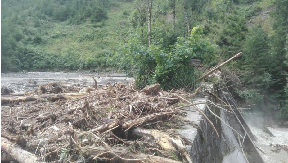
Bild 27: Der Murbrecher „Balkensperre“ mit randvoll gefülltem Retentionsbecken (Auffangbecken). Es hat Schlimmeres bei der Unwetterkatastrophe 2017 für den Ort Öblarn verhindert. © Wildbach- und Lawinerverbauung (WLV), Forsttechnischer Dienst.
